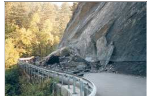
Chutes de blocs sur la RD 526 entre Mens et Clelles (Isère) en septembre 2001 © S. Gominet (IRMa)
